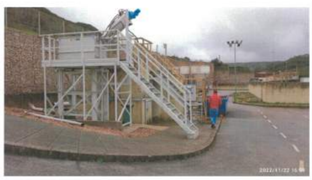
Figura 36 – Emp. Fornecimento e Montagem de Substituição de Equip. Eletromecânicos - Zona Norte da AdTA – Lt 1
