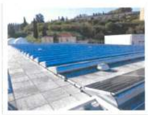
Figura 3B - Pormenor da central PV da FA Chelas
