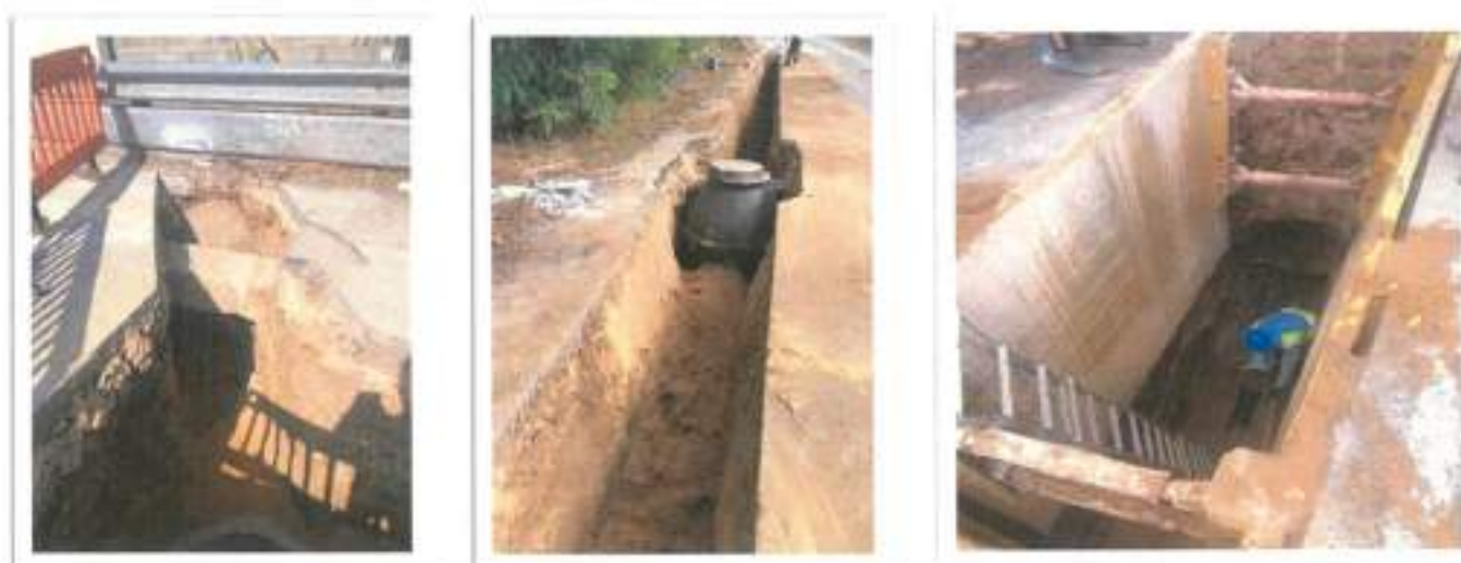
Figura 35 – Emp. Execução Troço de Jusante do Intercetor do rio Silveira e Reab. do Emissário Descorga de Dois Portos
