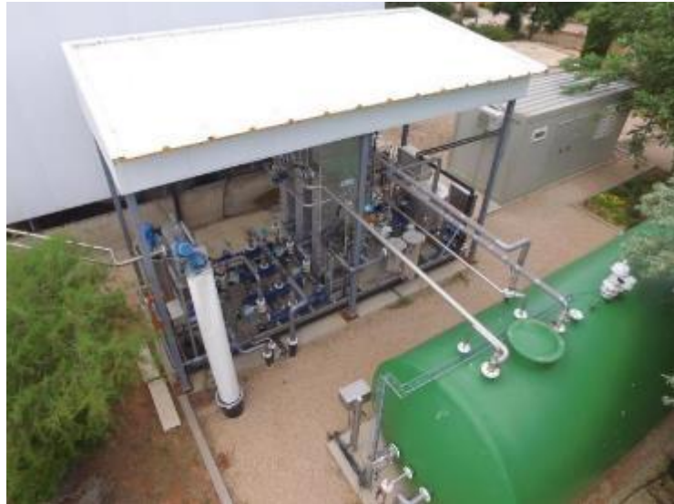
Location: Alcázar de San Juan WWTP (Ciudad Real, Spain)
